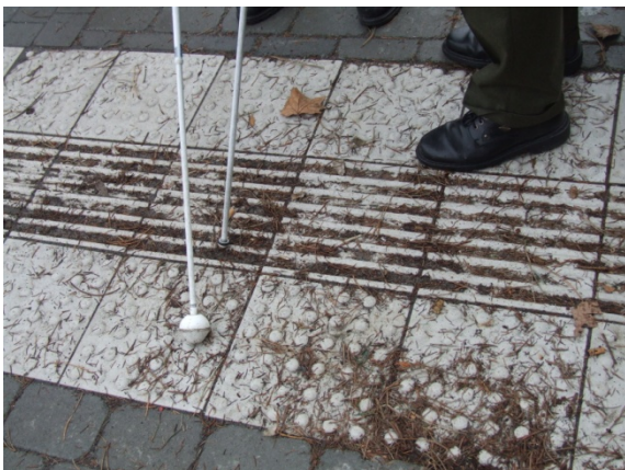
Auffindestreifen mit integriertem Richtungsfeld an Querungsstelle in Mörfelden-Walldorf (Hessen)
